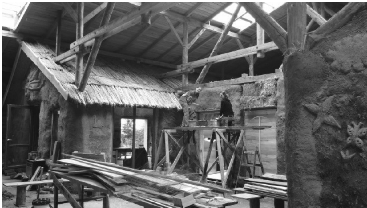
Obr. 4: Stavění hliněných domečků do velké vojenské dřevěné haly z II. světové války. Zabydlování Munu probíhá formou různých dobrovolnických či kulturních akcí a zajímavých projektů, které Munu kultivují.
