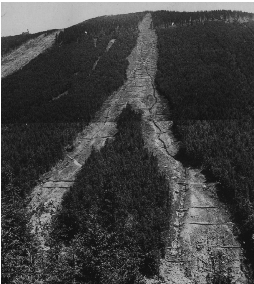
Obr. 5: Svahový sesuv č.1 v povodí Hučivé Desné po technických opatřeních, provedených v roce 1925 – 26 (odvedení povrchové vody dlážděnou kaskádovitou kynetou, stabilizace svahu palisádovými plůtky) (1927).
