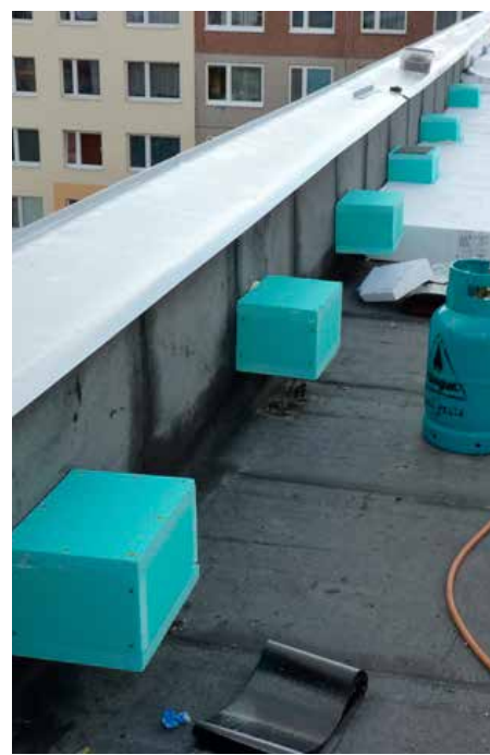
V případech, kdy nelze zachovat původní dutiny, například změnou režimu střechy na nevětranou, stále existuje způsob kompenzace původních hnízdních prostor instalací hnízdních boxů z XPS za atikový panel.
