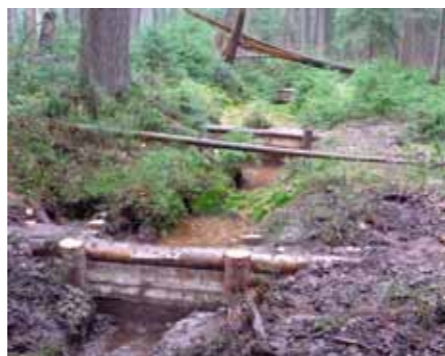
Dvojitá přehrázka na hlavním odvodňovacím kanálu v PR V Podolánkách
